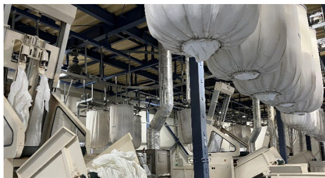
工場内工程間の自動搬送設備 (ヤマシタ 千葉事業酒々井工場)
